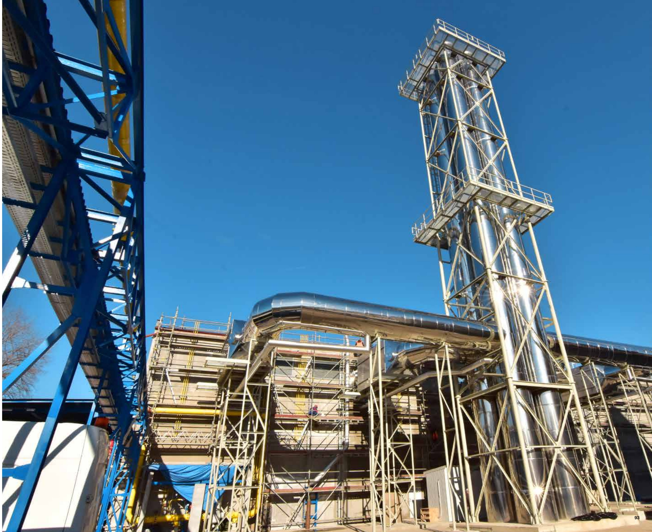
Plynová kotelna v Trmicích Boiler room in Trmice
