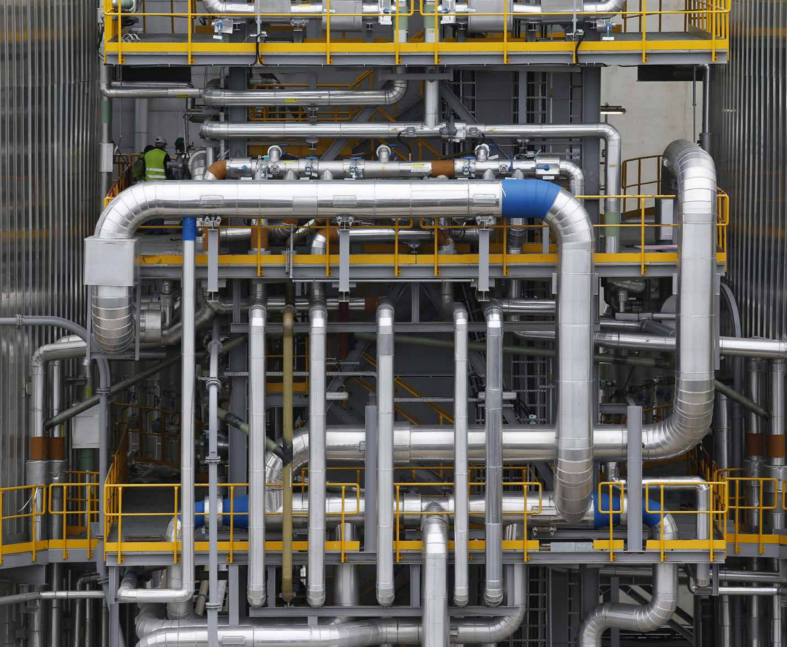
Elektrárna Mělník Mělník Power Station
